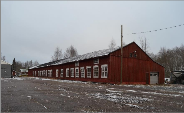
Kuva 15. Sahan entinen tuotanto- ja varastorakennus kuvattuna lännestä. Rakennuksen molempiin päihin on uusittu jossain vaiheessa ovet.
