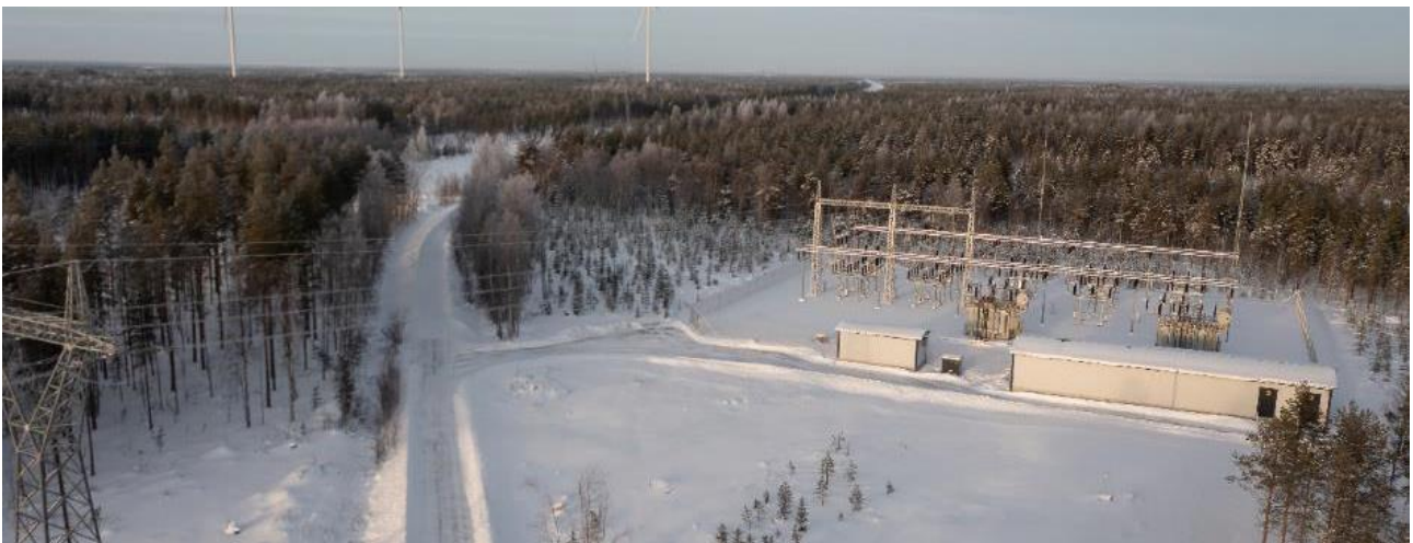
Kuva 17: Sähköasema, kuvituskuva ©FCG
